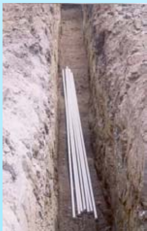
Sistema de Drenagem Interna da B.S. Colada ao Fundo do Cut Off
