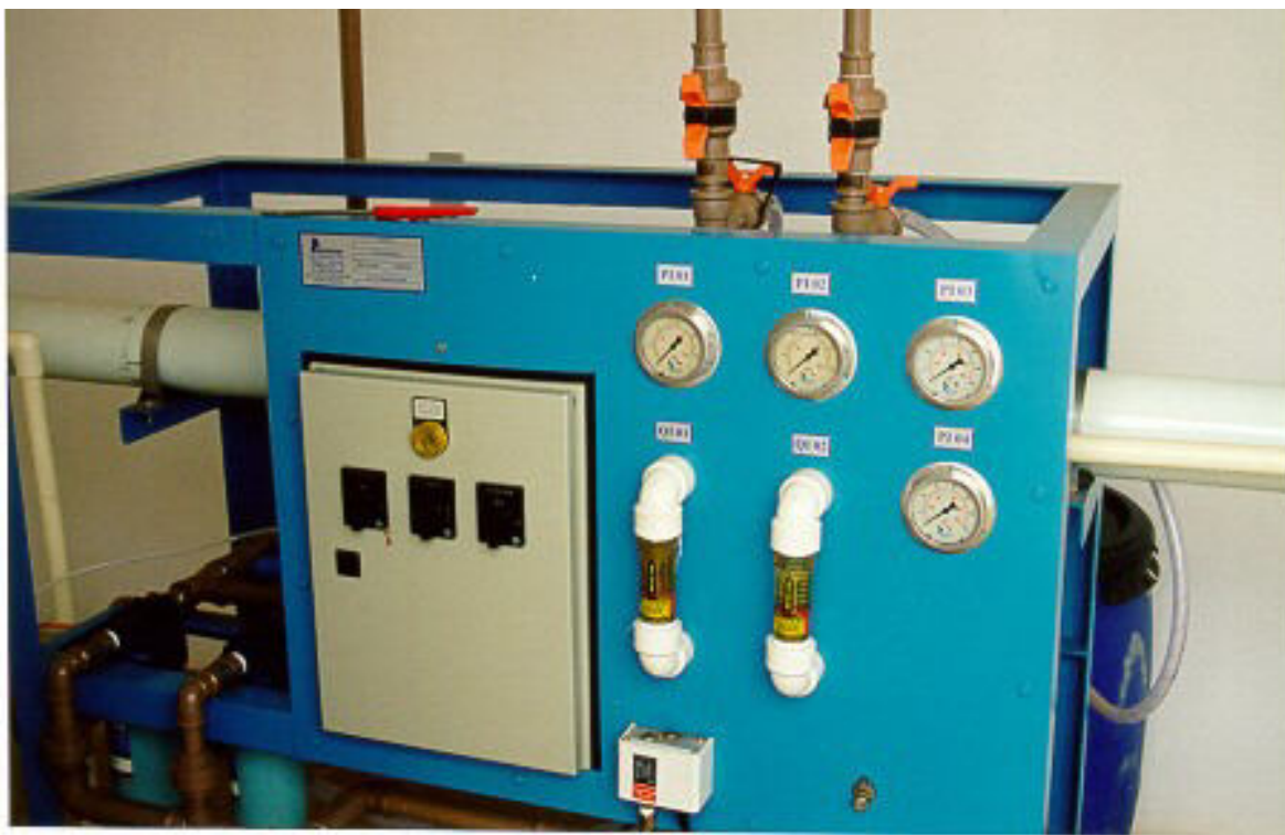
Figura 25: Detalhe do Dessalinizador
