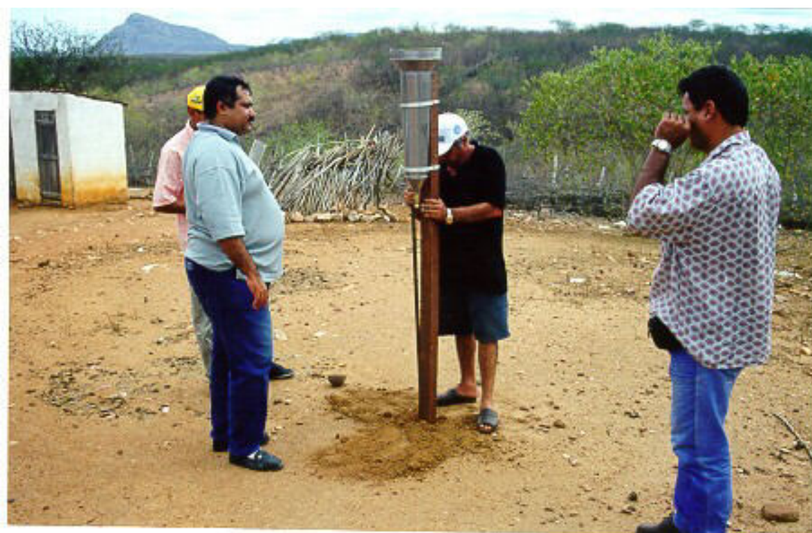
Figura 5: Instalação do Pluviômetro.
