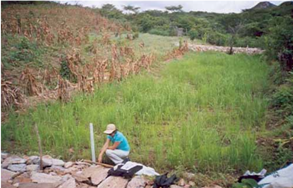
Foto 2 – Barragens de Contenção de Sedimentos
