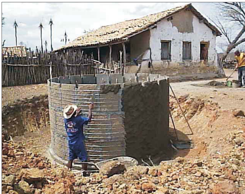
Foto 8 – Aspectos do Reboco Externo da Cisterna
